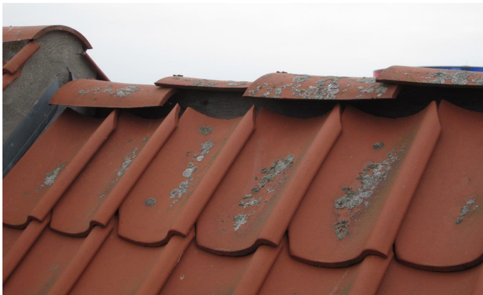
Figur 4-14 Tagrenovering og efterisolering er bekosteligt og skal ofte afvejes i forhold til boligforbedringer, som alle beboerne mærker.
