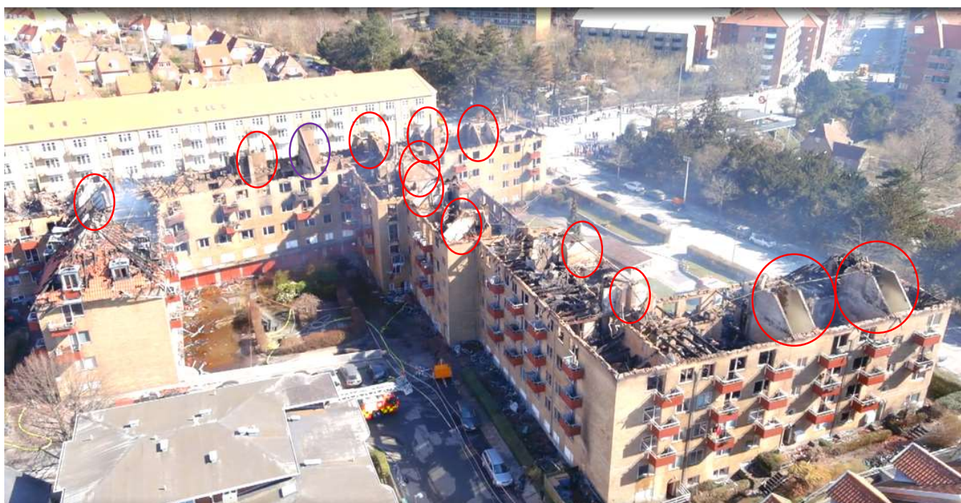
Figur 12 EF Grøndalpark - Billede af TV2 Lorry. Røde cirkler markerer trappeopgange og lilla cirkel markerer brandvæg.
