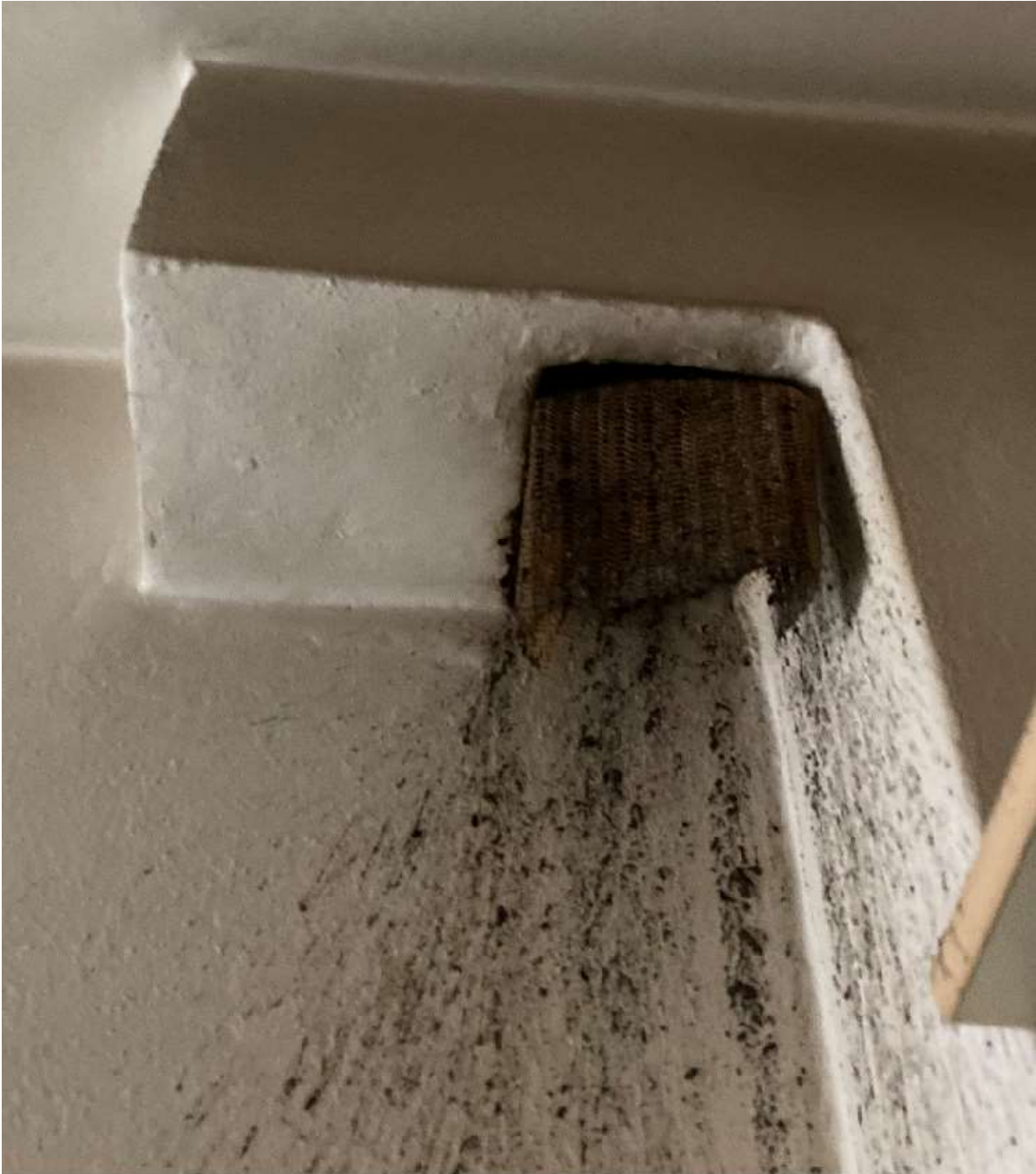
Figur 21 DBI – 28. marts 2022. Ventilationskanal i køkken. Slukningsvand fra slukning af brand i spidsloftet.
